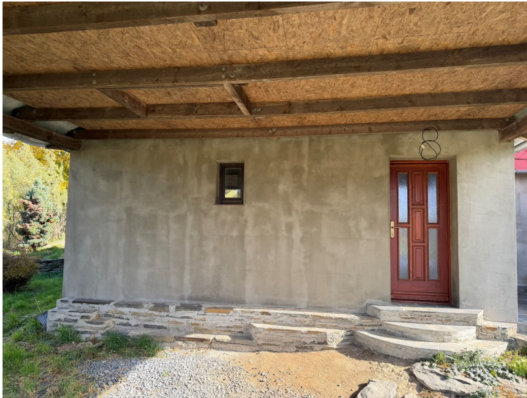
Chybějící vnější omítka
