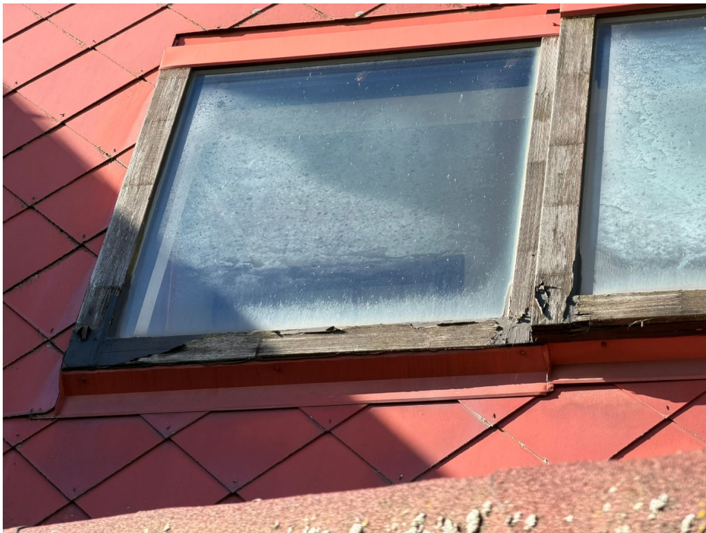
Opotřebený nátěr dřevěných ráků
