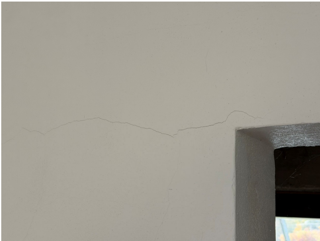
Praskliny na omítce
