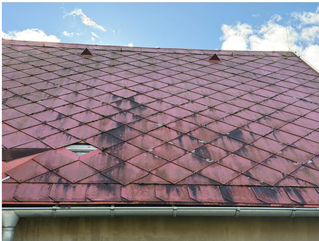
Znečištění střešní krytiny
