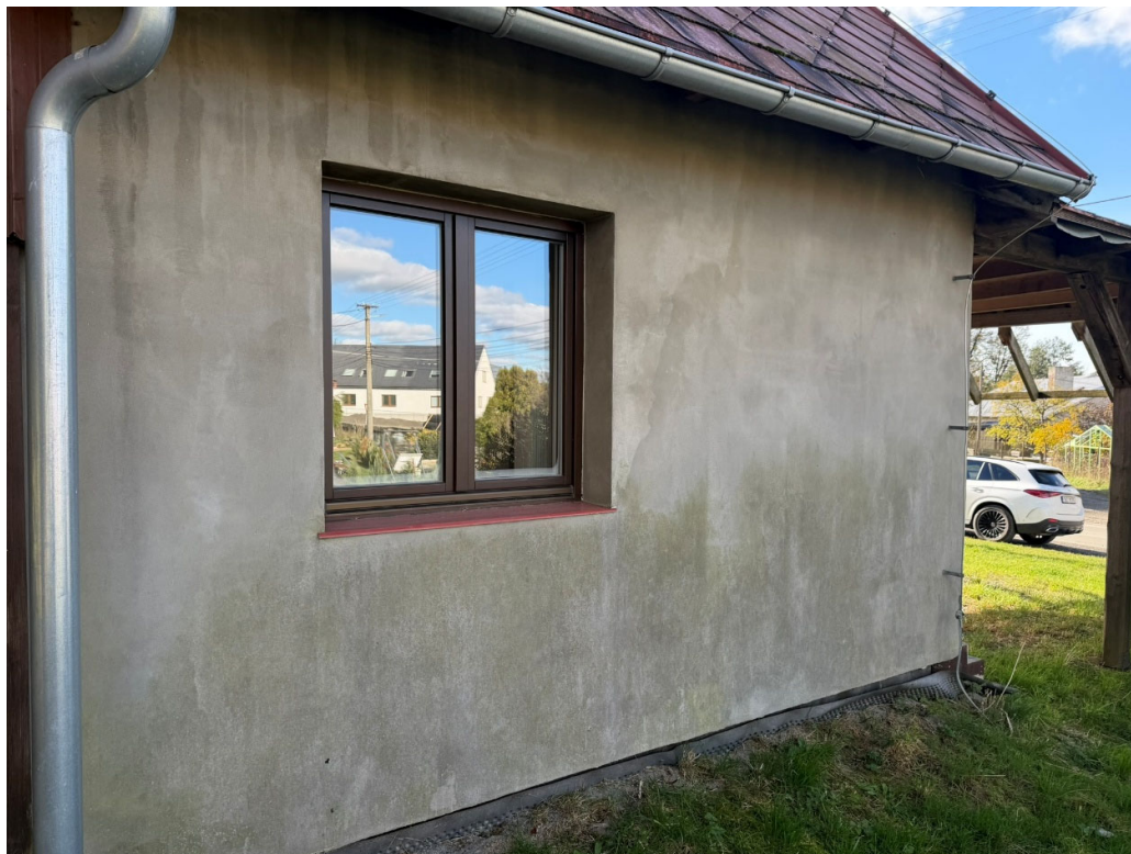
Chybějící vnější omítka
