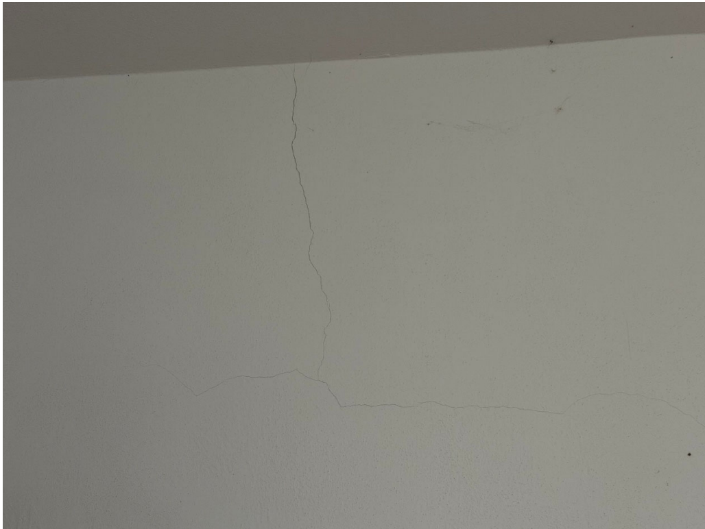
Praskliny na omítce
