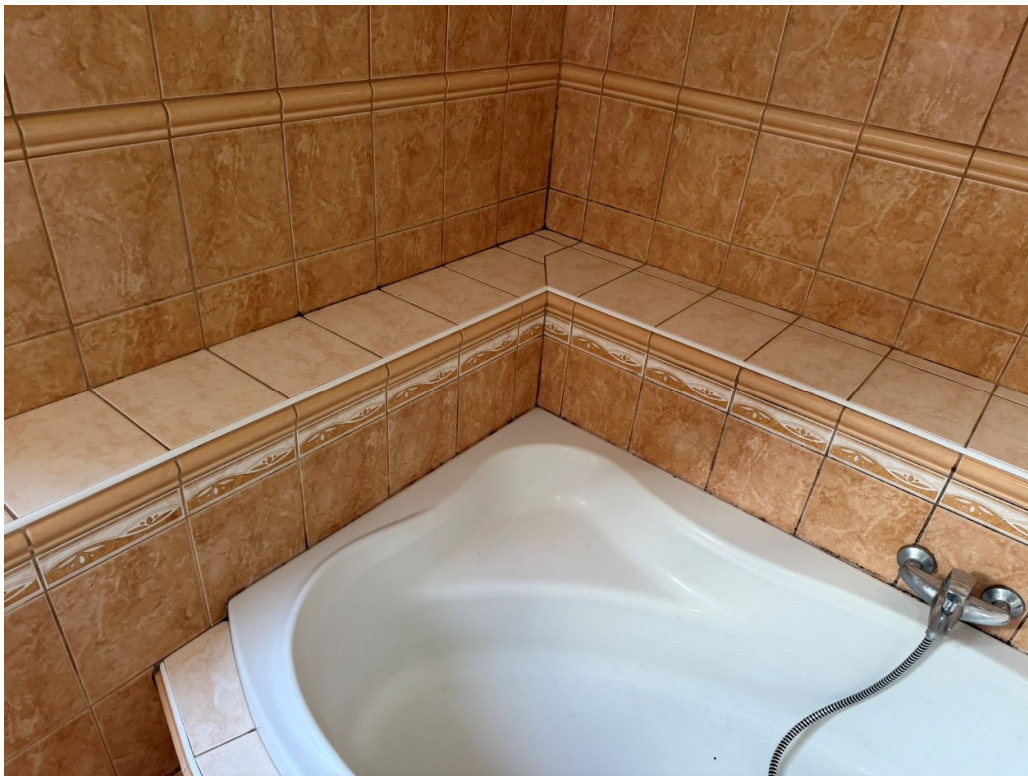
Plíseň u spárovací hmoty v místech kolem vany
