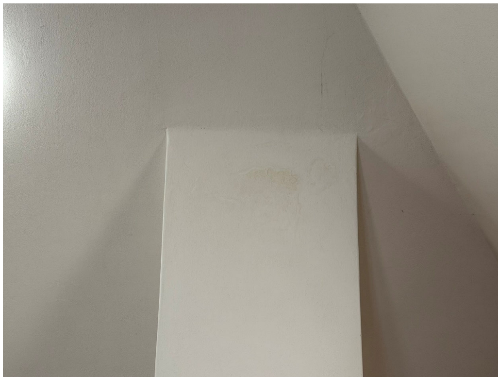
Skvrna od vody u komínu
