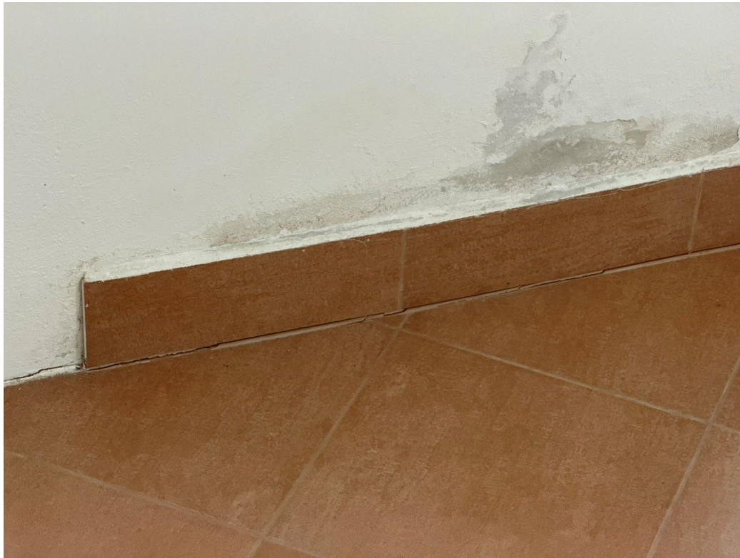
Skvrny na omítkách – nejedná se o poškození od zemní vlhkosti
