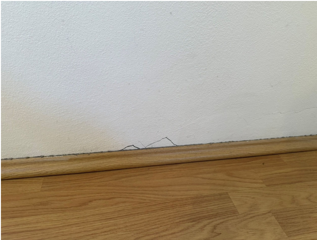
Praskliny na omítce
